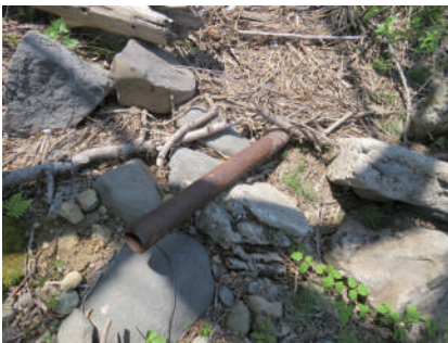
図62 80cmほど土中から出ている鉄管
