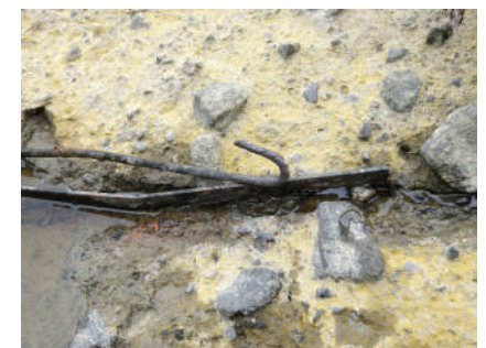
図70 川原に埋まる鉄筋や鉄板
