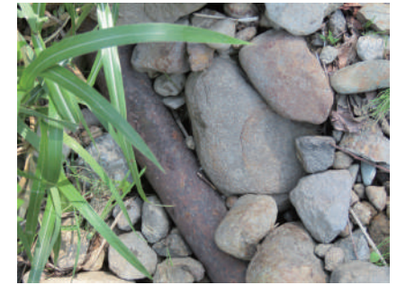
図61 流失して壊れた石積の下の斜面で土中から覗いていた鉄管
