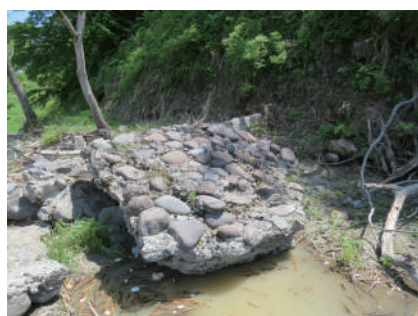
図42 図41の矢印付近で逆さになったコンクリート塊
