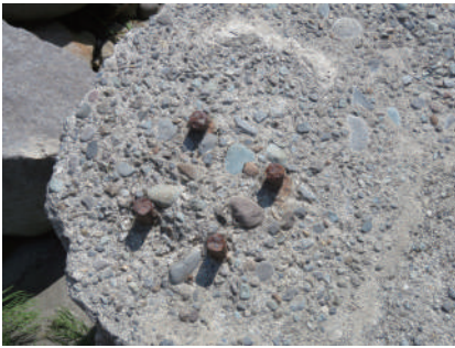
図59 鉄筋が4本突き出たコンクリート塊
