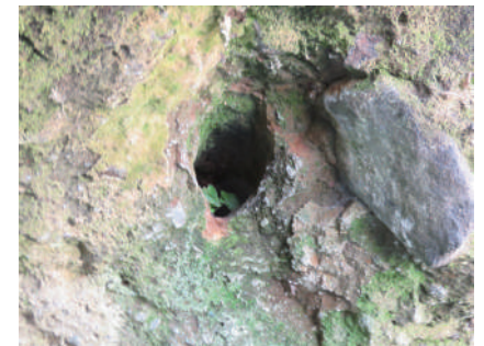
図64 入口右側の壁面に空いた穴。人工的に掘った穴か？
