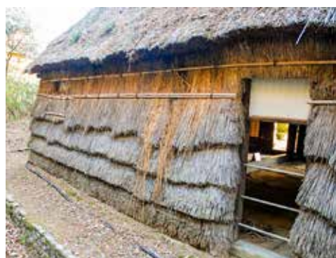
古くなった茅壁が垂れ下がる様子
