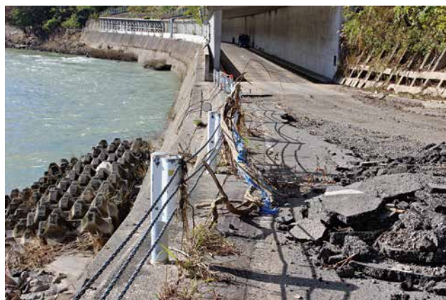
写真8 壊れたアスファルト路面
