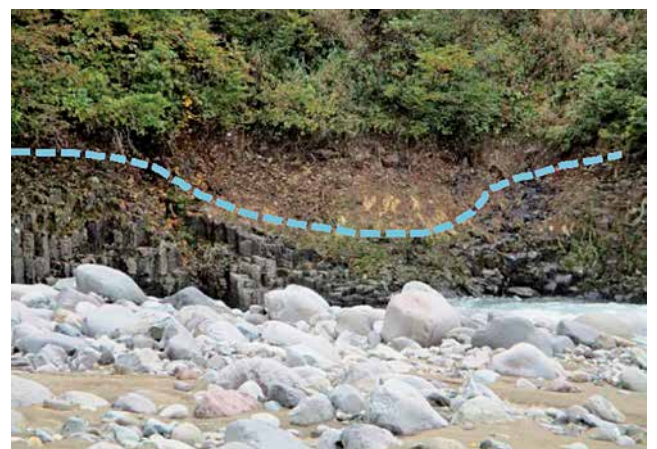
写真14 破線から上の柱状節理の崩壊流出
