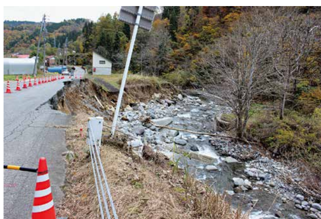
写真17 激流による路肩崩壊
