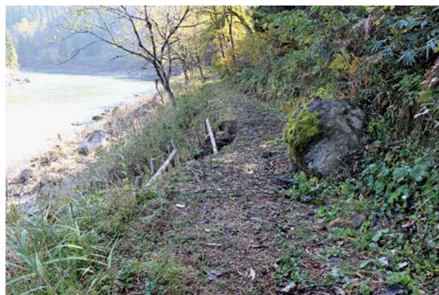
写真4 小滝地内 古道の被害
