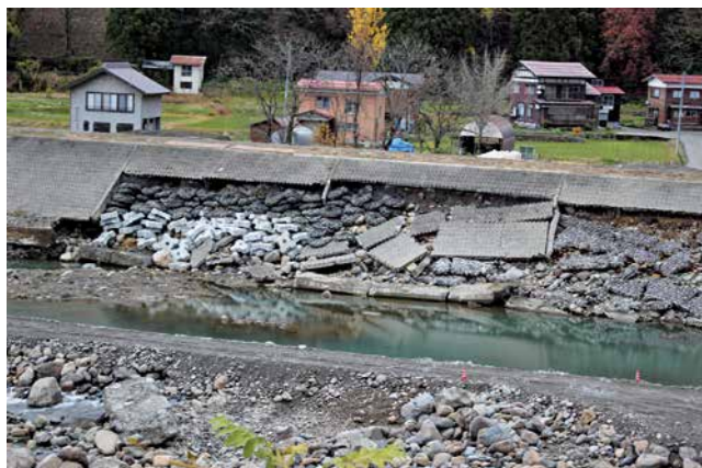
写真7 崩壊した堤防のブロック
