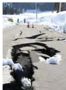
長野県北部地震の被害の様子
