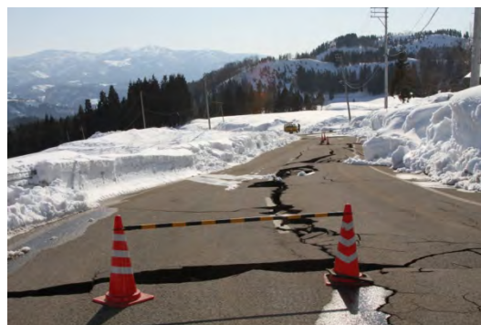
長野県北部地震により寸断された道路
